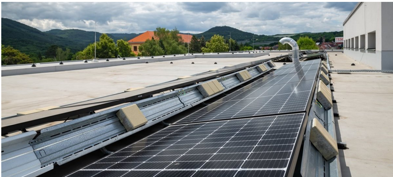
Strešná fotovoltaická elektráreň
