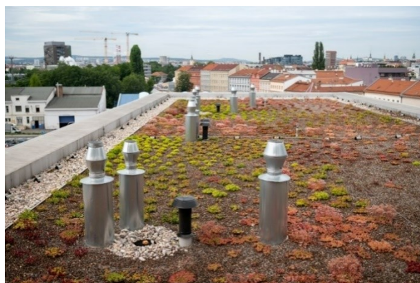
Vegetačná strecha v Brne na ul. Svatopeterská
